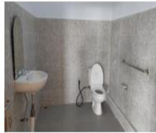
Toilet Khusus Difabel
